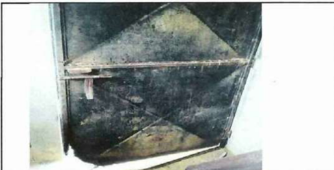
Foto 3: Se observa la necesidad de la colocacion de nuevas puertas para mayor seguridad en las entradas de las aulas
